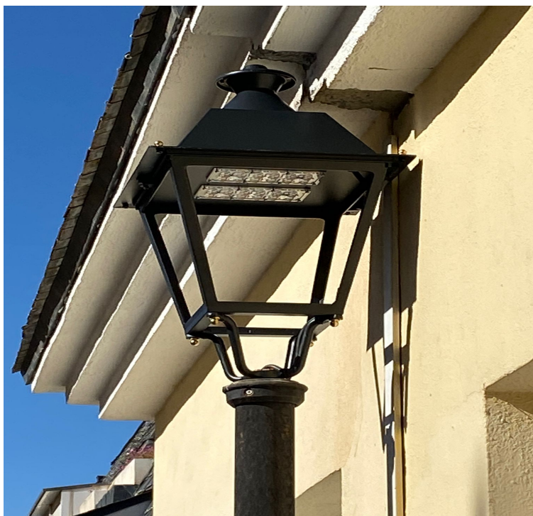
Foto 4: Nueva Luminaria en Camino del Encantado.
