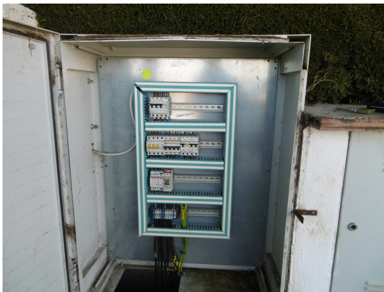
Foto 1: Cuadro eléctrico antes de la reforma.
