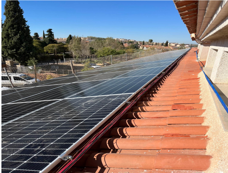
Foto 12: Planta Solar Fotovoltaica instalada en CEIP Ramón y Cajal.
